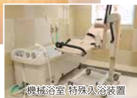
機械浴室（特殊入浴装置）
